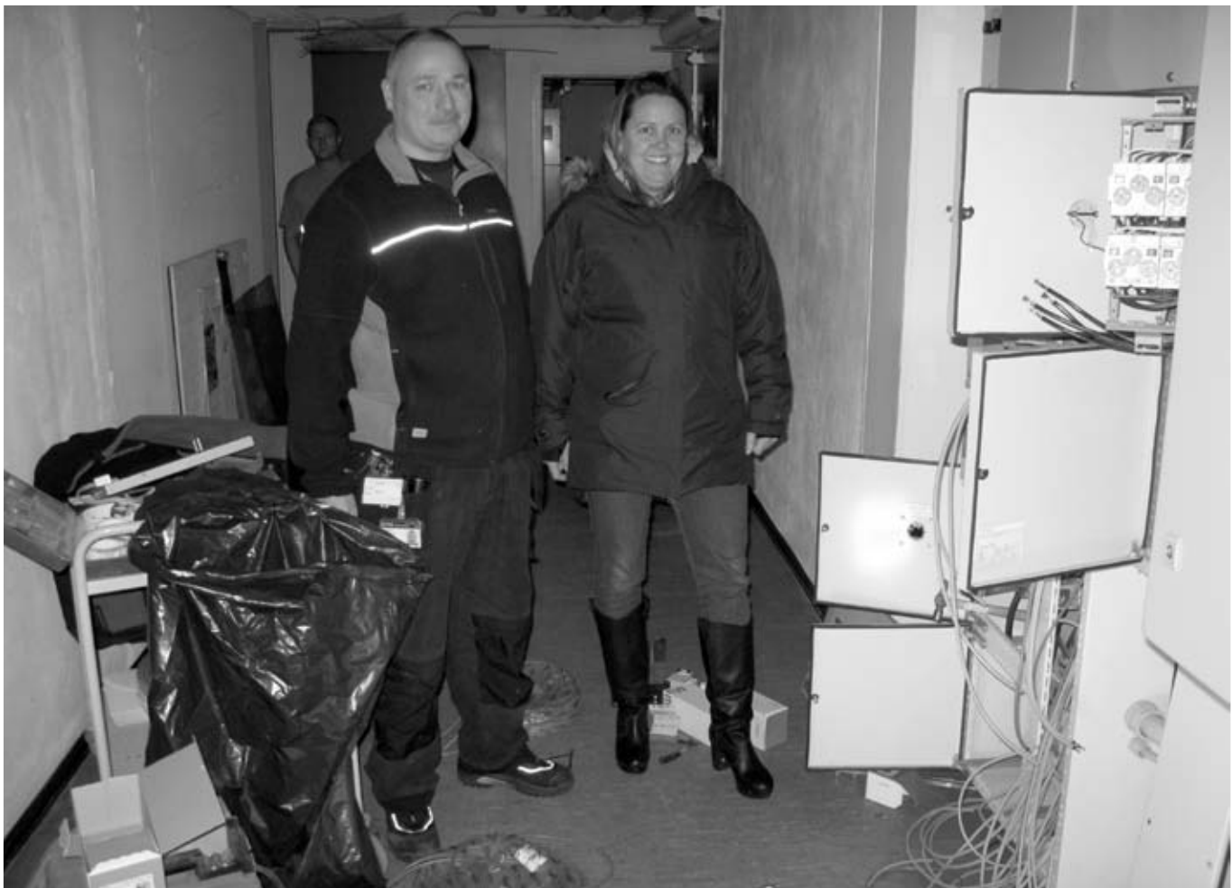
Irene Boese og overmontør Tonny Pedersen ses her i bygning 18, hvor el-tavlerne blev opgraderet og udskiftet i december 2011.
